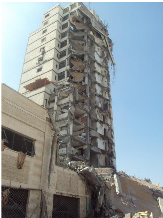
Ville de Gaza : le complexe italien, bande de Gaza, août 2014 © Amnesty International
